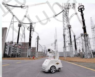
变电站噪声检测
